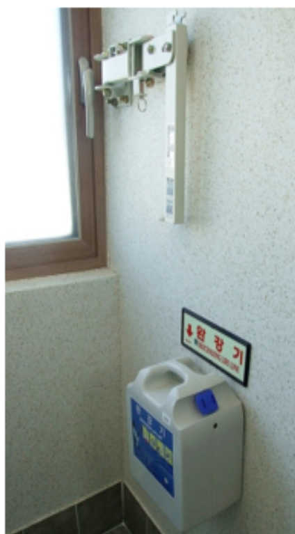
<완강기 설치 상태>
