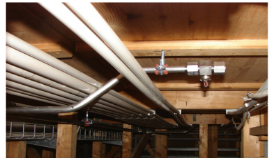
<벤딩된 튜브에 설치된 미분무헤드>
