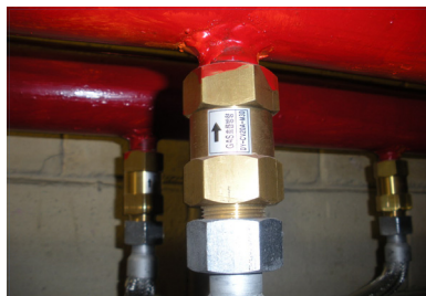
[그림 8] 저장용기와 집합관 연결부에 설치된 체크밸브
