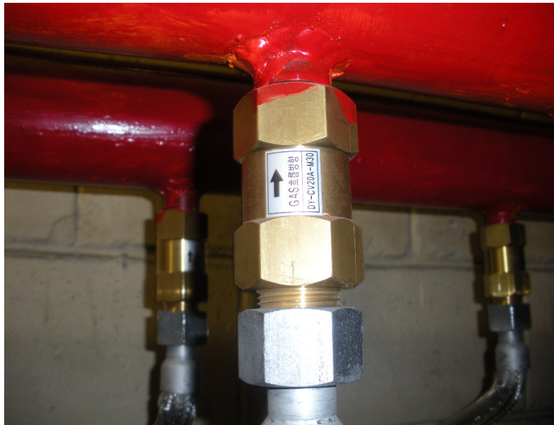
[그림 7] 저장용기와 집합관 연결부에 설치된 체크밸브
