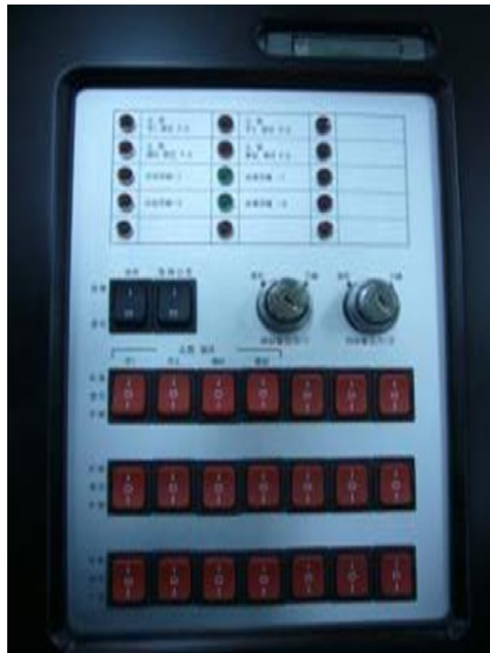
소화펌프 제어장치 및 표시장치 사례
