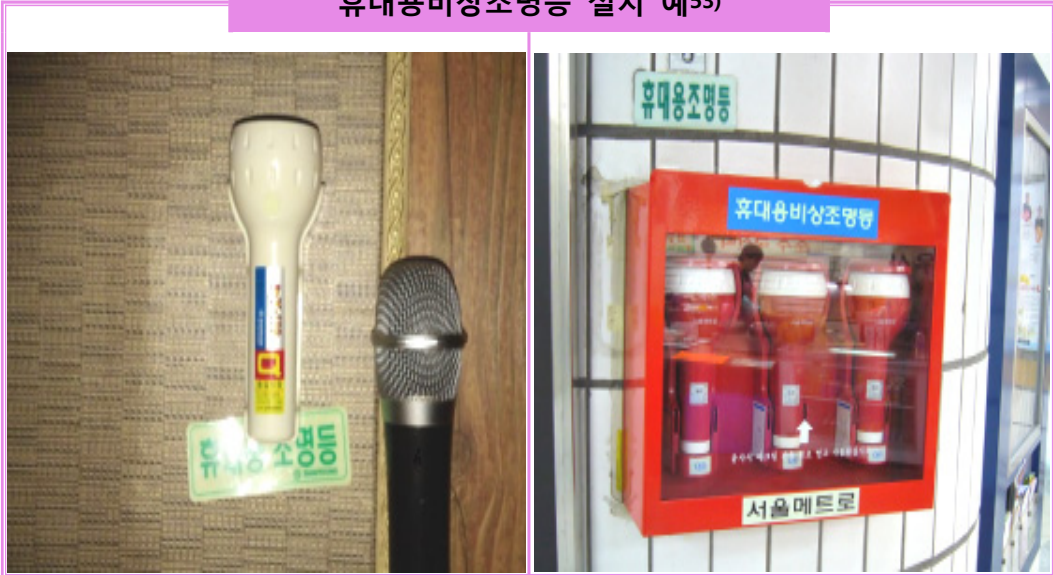
휴대용비상조명등 설치 예53)
