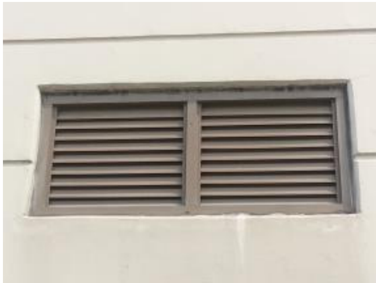
옥상에 설치된 제연 팬룸(급기그릴이 외부로 향한 사례)
