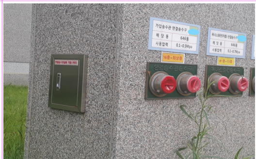
송수구 측면에 설치
