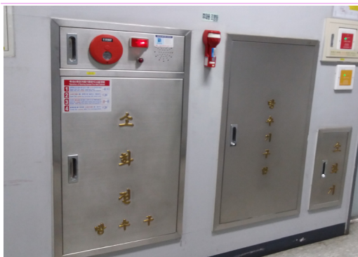
방수구함 겸용 옥내소화전함과 나란히 설치
