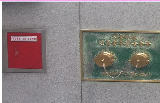
송수구 정면에 설치
