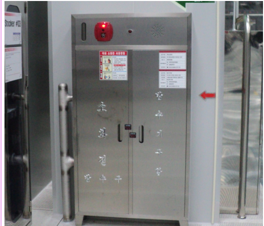
방수구함 겸용 옥내소화전함과 일체형
