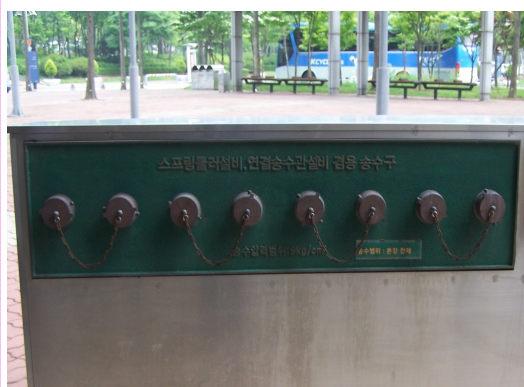
쌍구형 4개 설치된 경우 (겸용 송수구/○○ 전시관)
