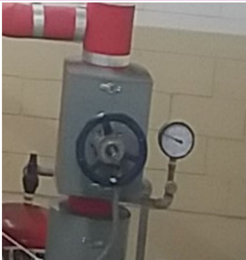
잘못된 설치(배관 내의 정압 지시)
