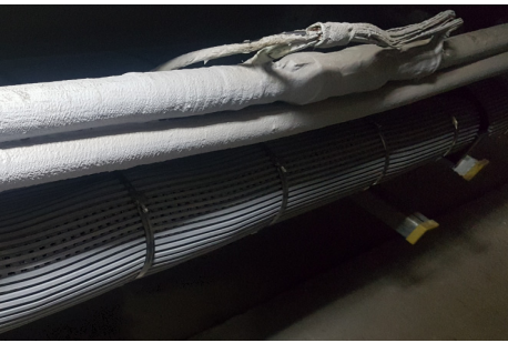
난연도료가 도포된 케이블 접속부
