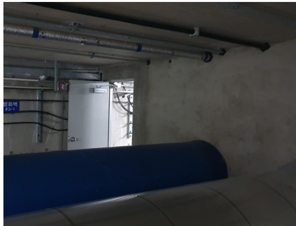
방화벽 관통부위 내화충전구조의 설치사례
