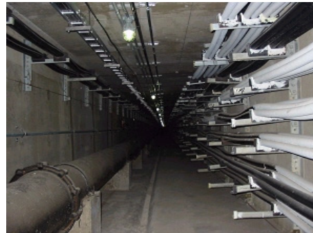
공동구(전기, 통신, 상수도)
