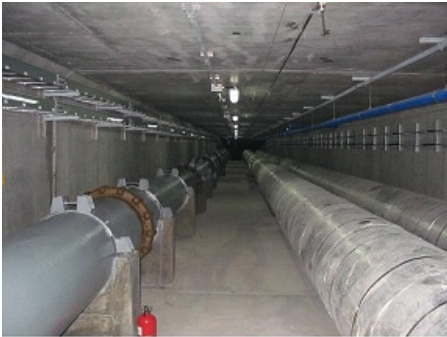
공동구(전기, 통신, 냉난방, 상수도)
